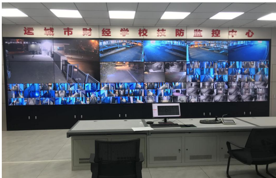
图 7-11 运城市财经学校技防监控中心
